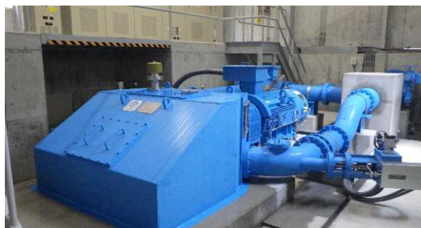
奥伊吹第二発電所 水力発電機
